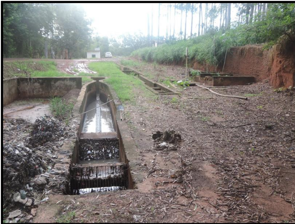
Imagem 43 – vista das duas caixas de areia (antiga e nova)
