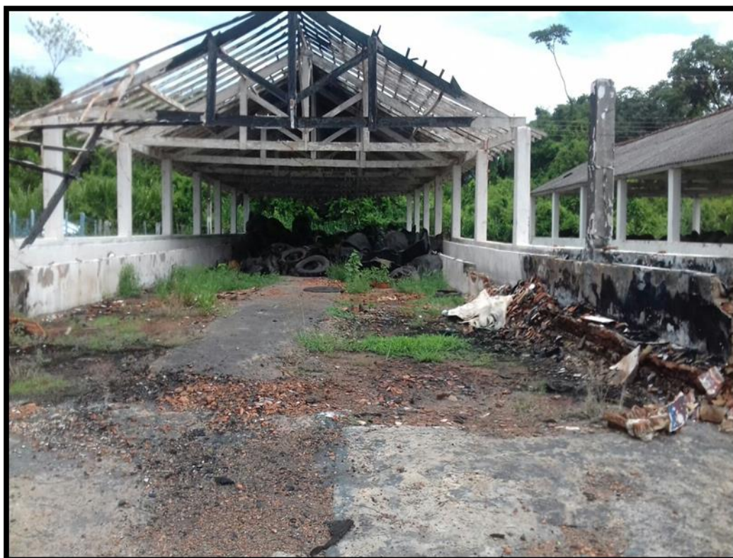
Imagem 112 – Barracão onde são armazenados os pneumáticos
