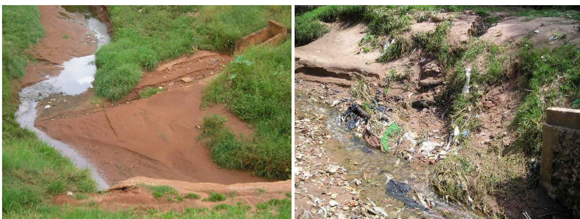
Imagem 56 – Assoreamento de córregos e presença de resíduos sólidos nos canais de drenagem – Ponto crítico 5
