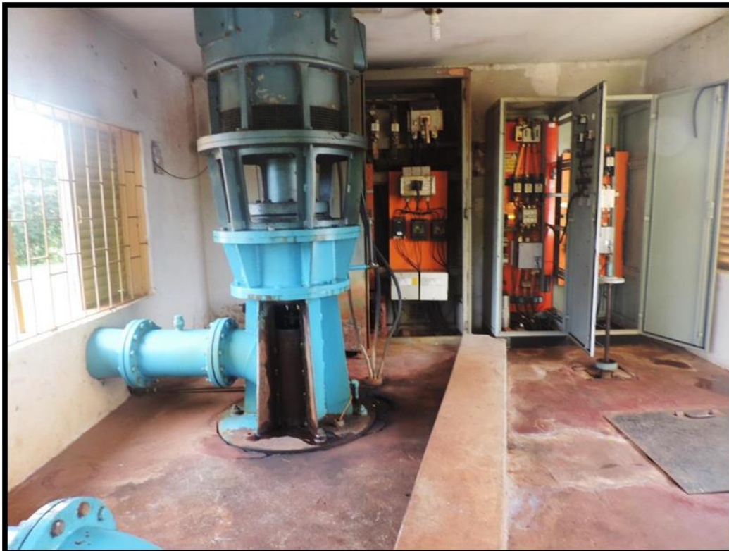
Imagem 18 – Casa de bombas da captação superficial no Córrego da Cabeceira Comprida
