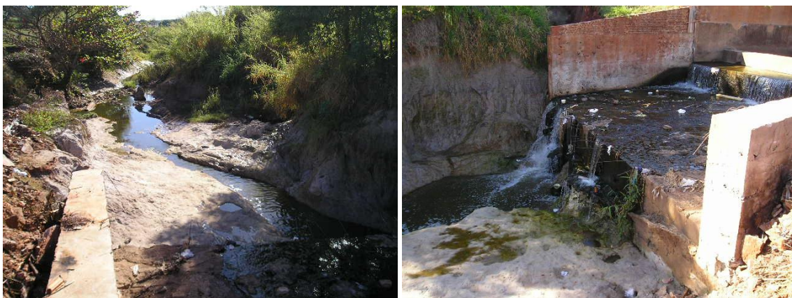
Imagem 52 – Necessidade de obras complementares de dissipação de energia no início do córrego da Mula – Ponto crítico 1
