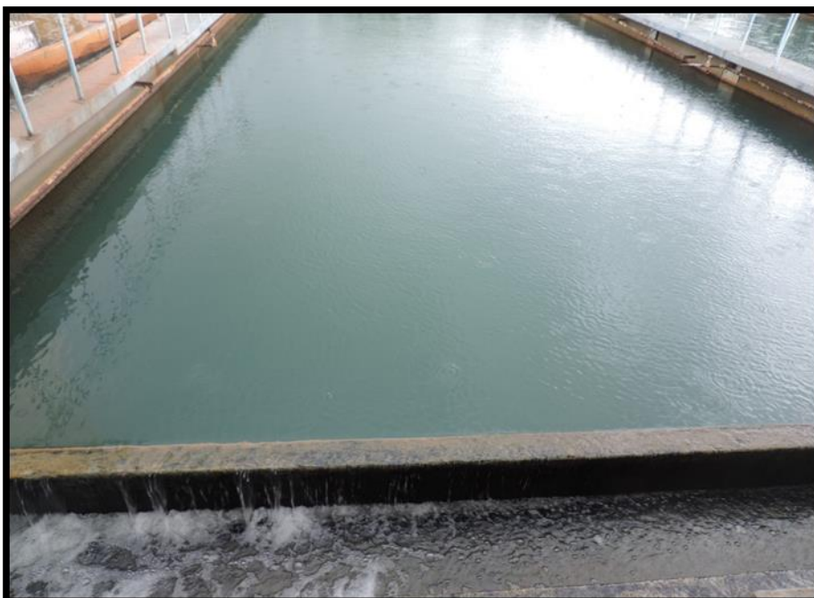
Imagem 27 – Tanque de decantação
