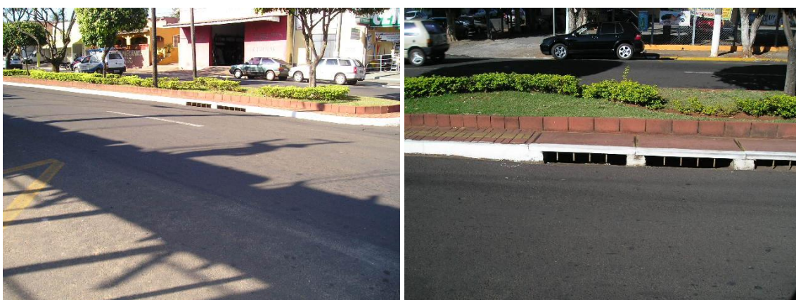
Imagem 47 – Bocas de lobo na Avenida Navarro de Andrade
