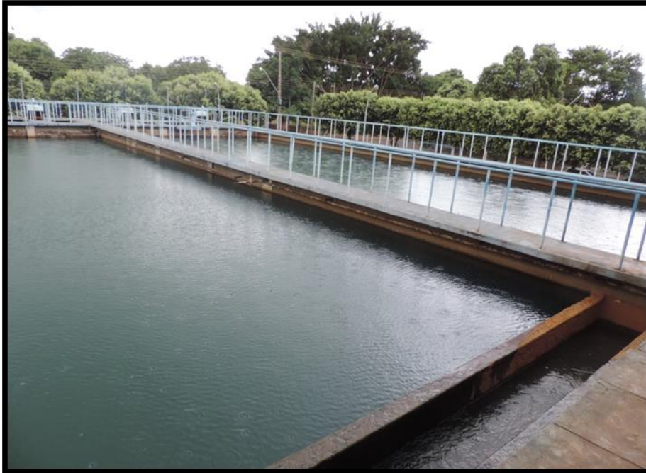
Imagem 26 – Tanque de decantação
