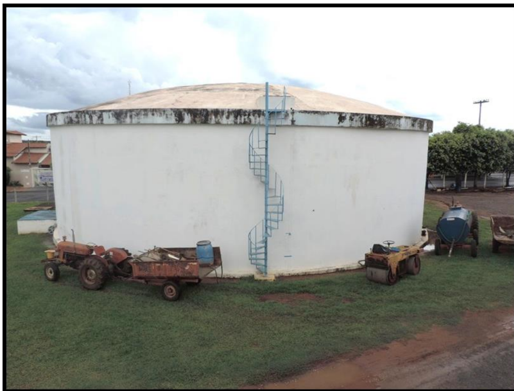
Imagem 21 – Reservatório Apoiado – ETA
