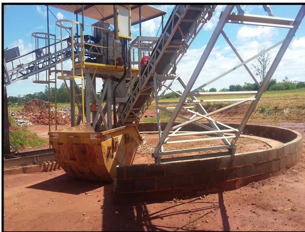
Imagem 95 – Usina de Britagem/Reciclagem de RCC
