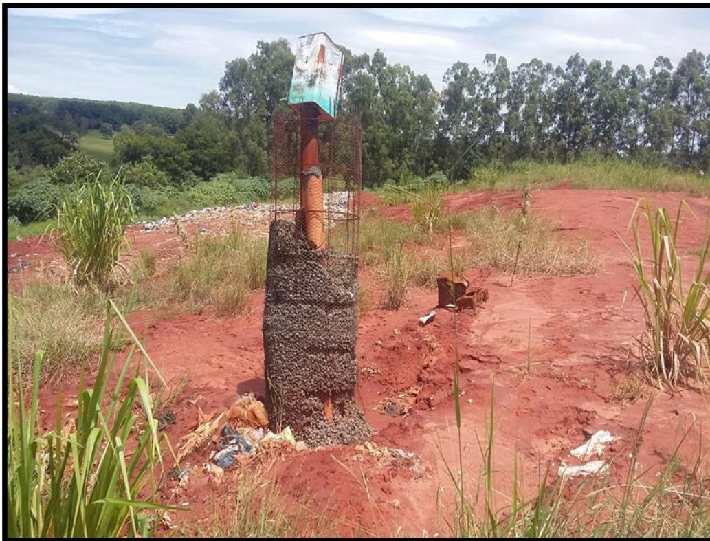
Imagem 86 – Dreno de Gás no Aterro Sanitário
