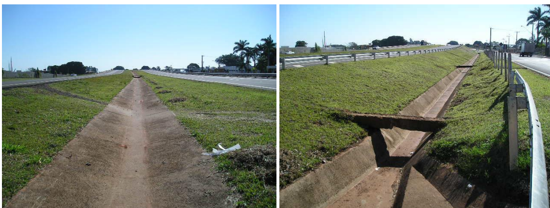
Imagem 46 – Rede de drenagem da duplicação da SP-320- aumentando a contribuição de águas pluviais
