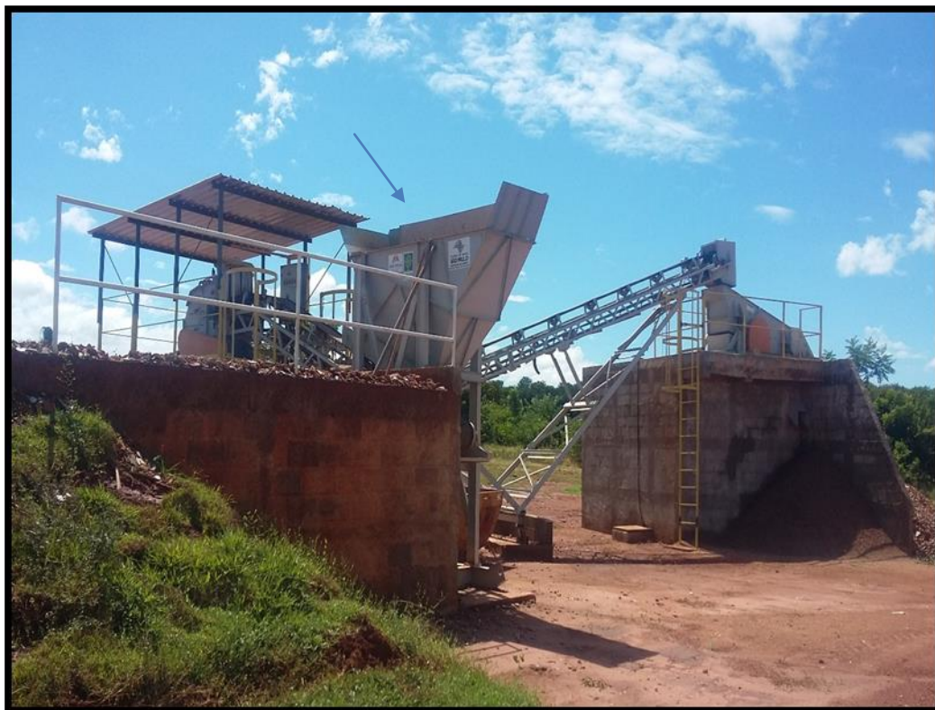
Imagem 96 – Alimentador da Usina de Britagem/Reciclagem de RCC
