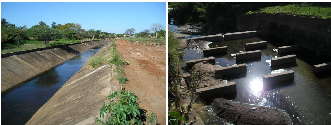
Imagem 50 – Trecho final do canal no Córrego Mangará e sistema de dissipação de energia no canal
