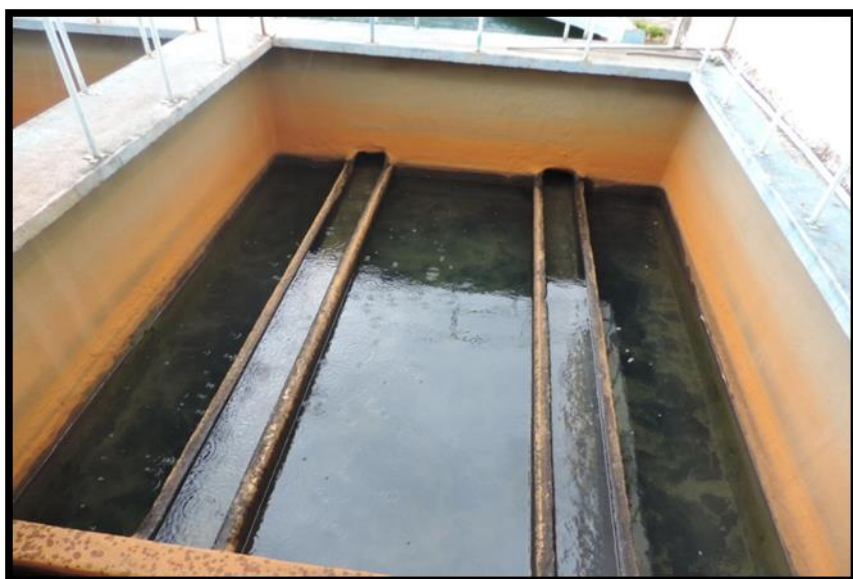
Imagem 29 – Tanque de filtração
