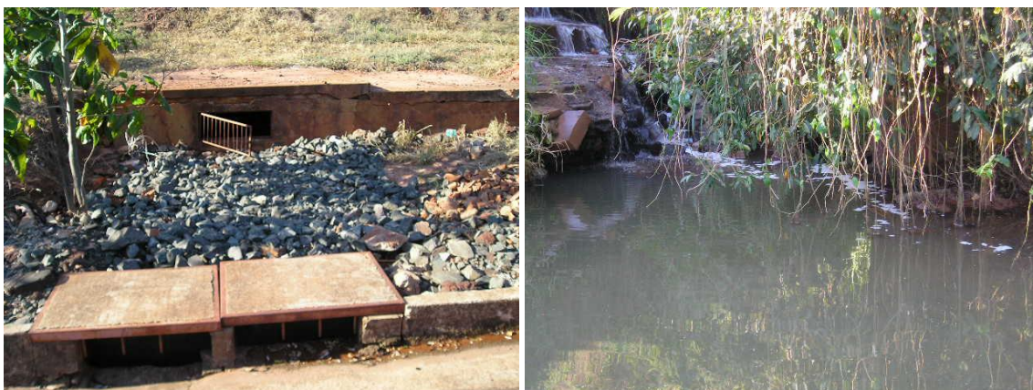
Imagem 54 – Sistema de captação e despejo do Córrego da Apae. Necessidade de obras de dissipação – Ponto crítico 3
