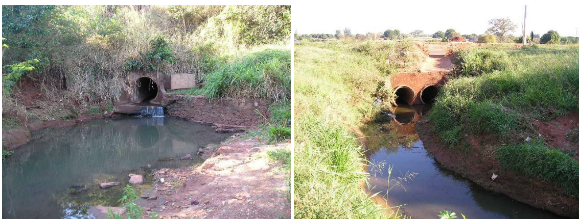
Imagem 53 – Despejo inadequado de águas pluviais à jusante da linha férrea – Ponto crítico 2
